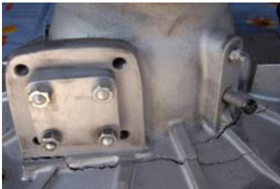
Durch Frost rundum geplatzter Pumpendeckel
