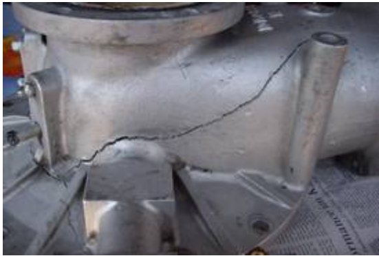
Durch Frost quer geplatzter Pumpendeckel
