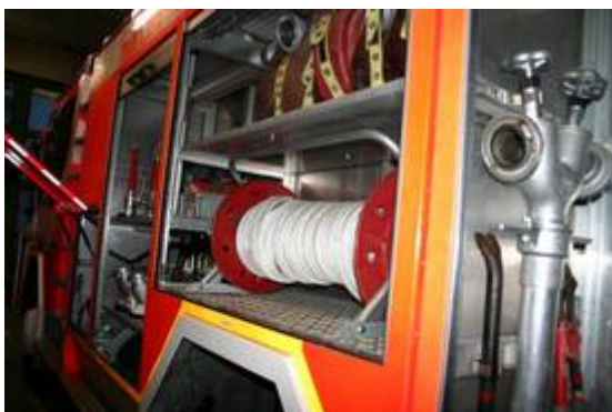
Wieder teilweise bestückte Geräteräume
